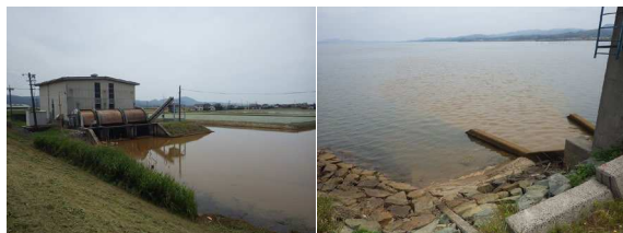
Fig. 1 （左）排水機場の遊水池、（右）排水機場から宍道湖に排水される様子。
